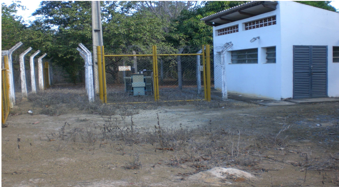
FOTO 01 : SUBESTAÇÃO ELÉTRICA ER-C3
