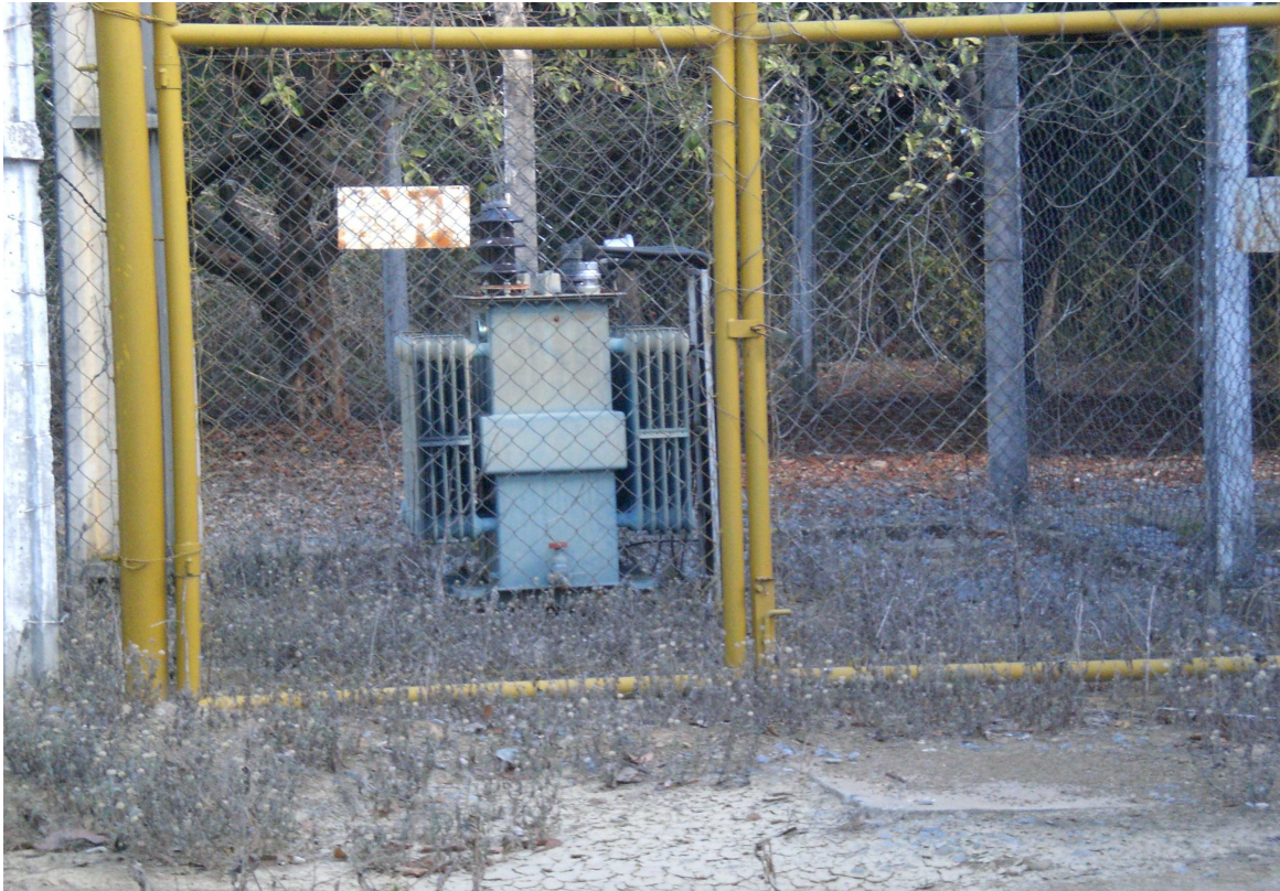
FOTO 02 : TRANSFORMADOR 225 KVA / SUBESTAÇÃO ELÉTRICA ER-C3
