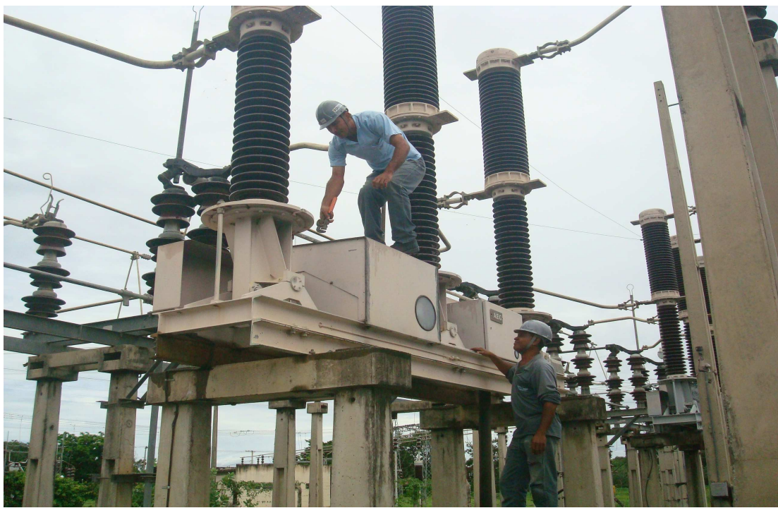
FOTO 02 : DISJUNTOR 138 KV DA SUBESTAÇÃO ELÉTRICA EB-1
