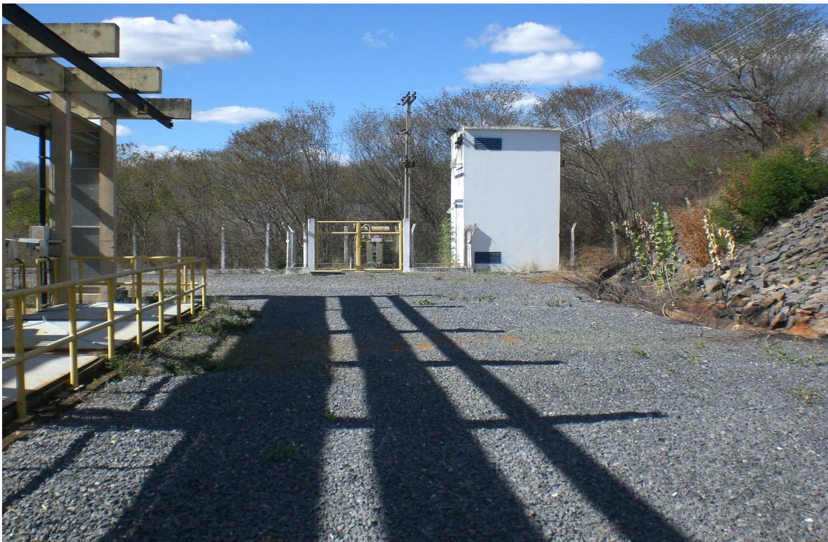
FOTO 03 : SUBESTAÇÃO ELÉTRICA ER-B
