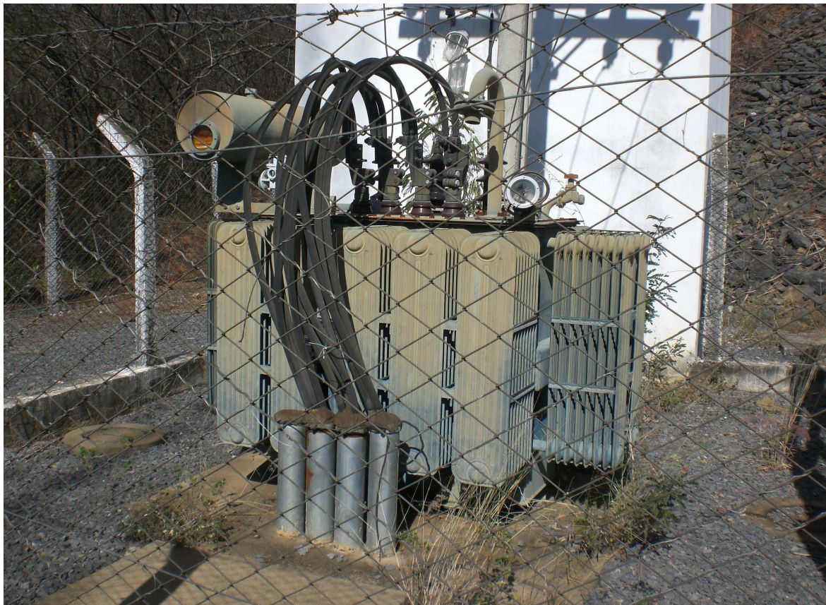
FOTO 05 : TRANSFORMADOR 1000 KVA /SUBESTAÇÃO ELÉTRICA ER-B
