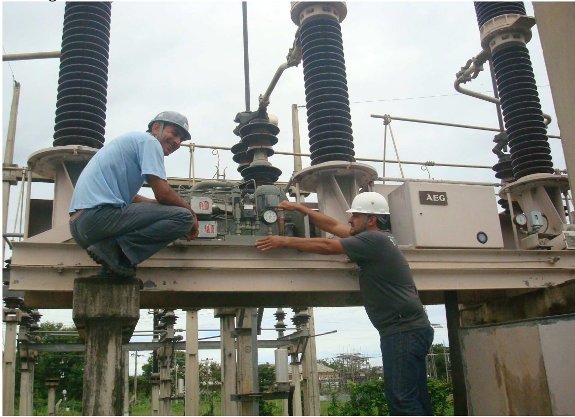
FOTO 01 : DISJUNTOR 138 KV DA SUBESTAÇÃO ELÉTRICA EB-1
